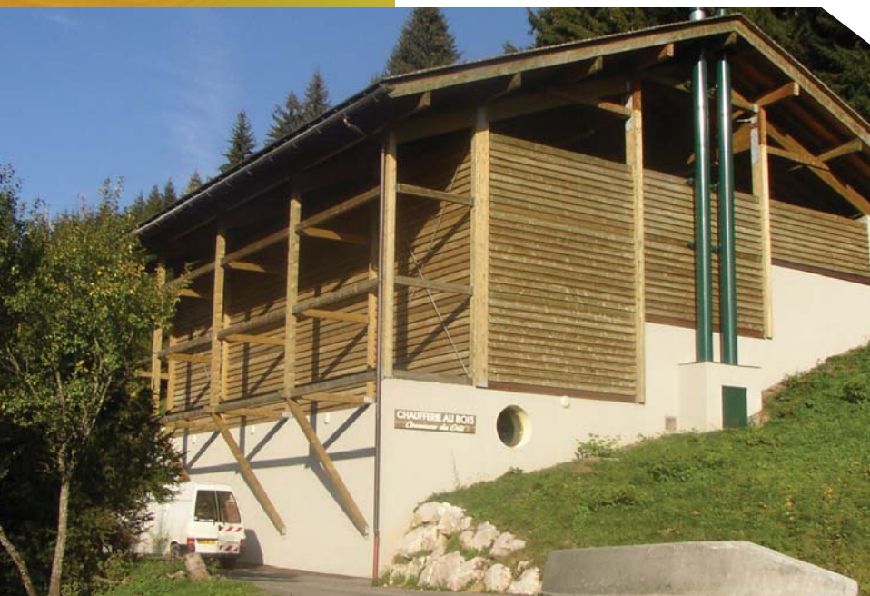
Vue de la chaudière automatique au bois déchiqueté.
