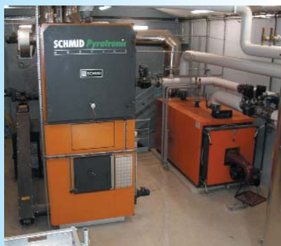
La chaudière bois (à gauche) et la chaudière fioul (à droite).
