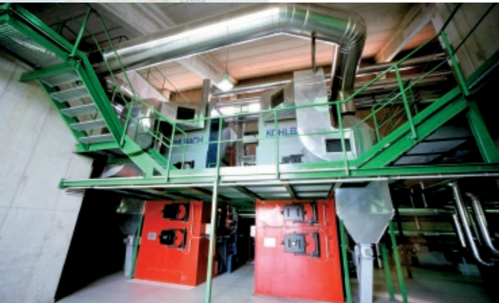
2 Heizkessel der Firma Kohlbach mit der Gesamtleistung von 4 MW
