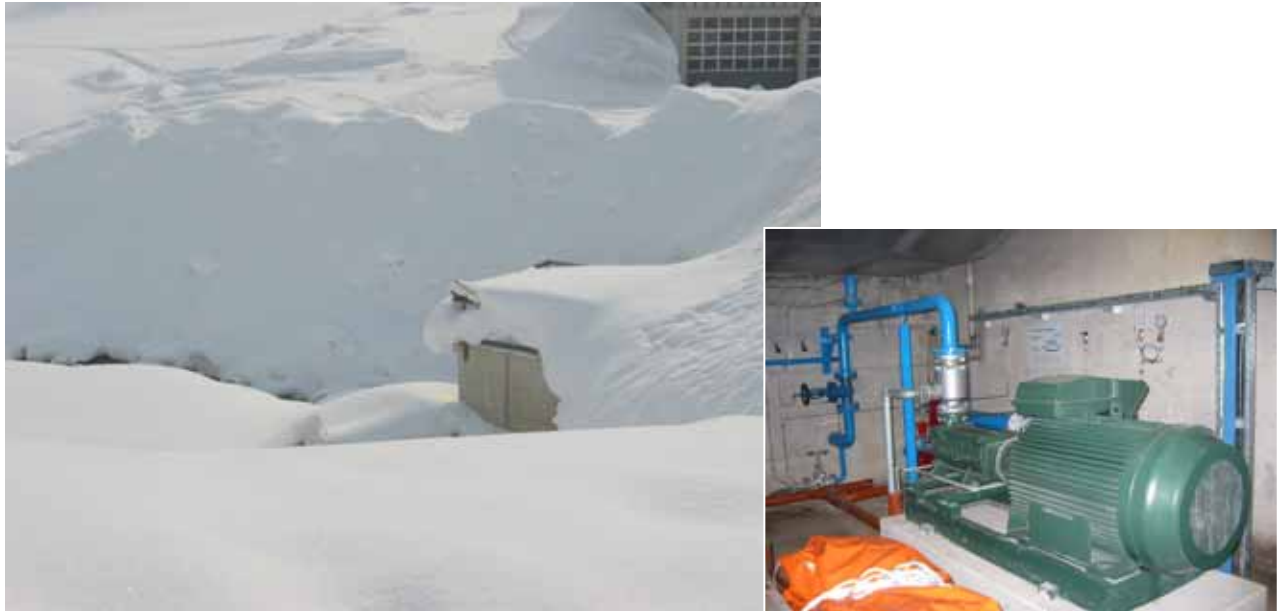
Wasserfassung Krumbach / Kuchlbach bei Talstation Jägeralp-Express, Pumpstation im Talstationsgebäude
